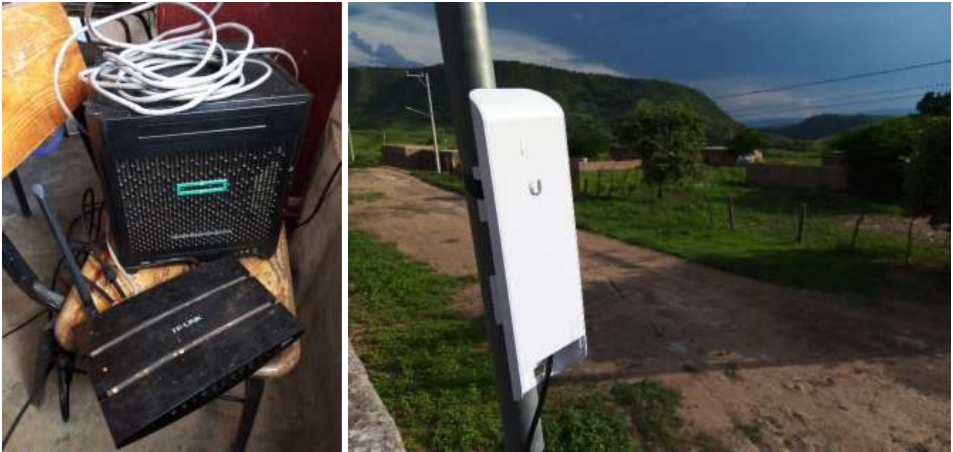
Fotos: Servidor local, router wifi y antenas para compartir red local en la comunidad
